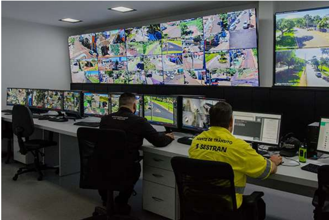
Central de Controle Operacional – Projeto Cambé + Segura
