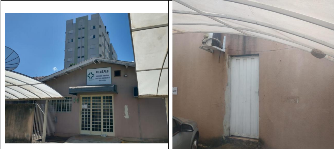
ESQUERDA: Entrada de prédio público utilizado pelo setor de sindicância - Rua Portugal nº 44 - centro – DIREITA: Vespas localizadas na cobertura dos veículos oficiais, parte interna do imóvel - Data: 13/10/2025 - 15:15 horas;
